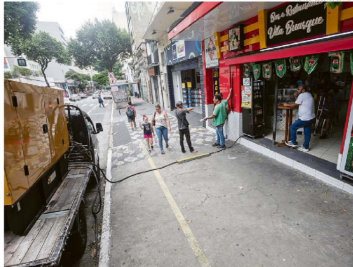
Estabelecimentos decidiram dividir os custos de R$ 2 mil por seis horas de uso ininterrupto do gerador
