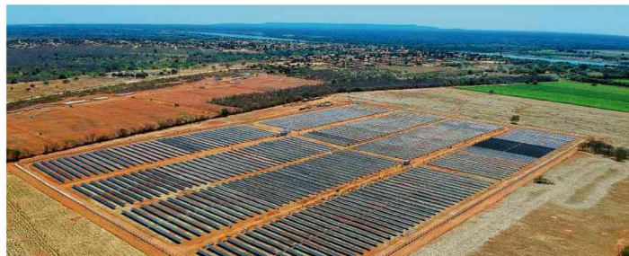
Usina fotovoltaica financiada pelo BDMG (Banco de Desenvolvimento de Minas Gerais) na cidade de Manga (MG) Divulgação
