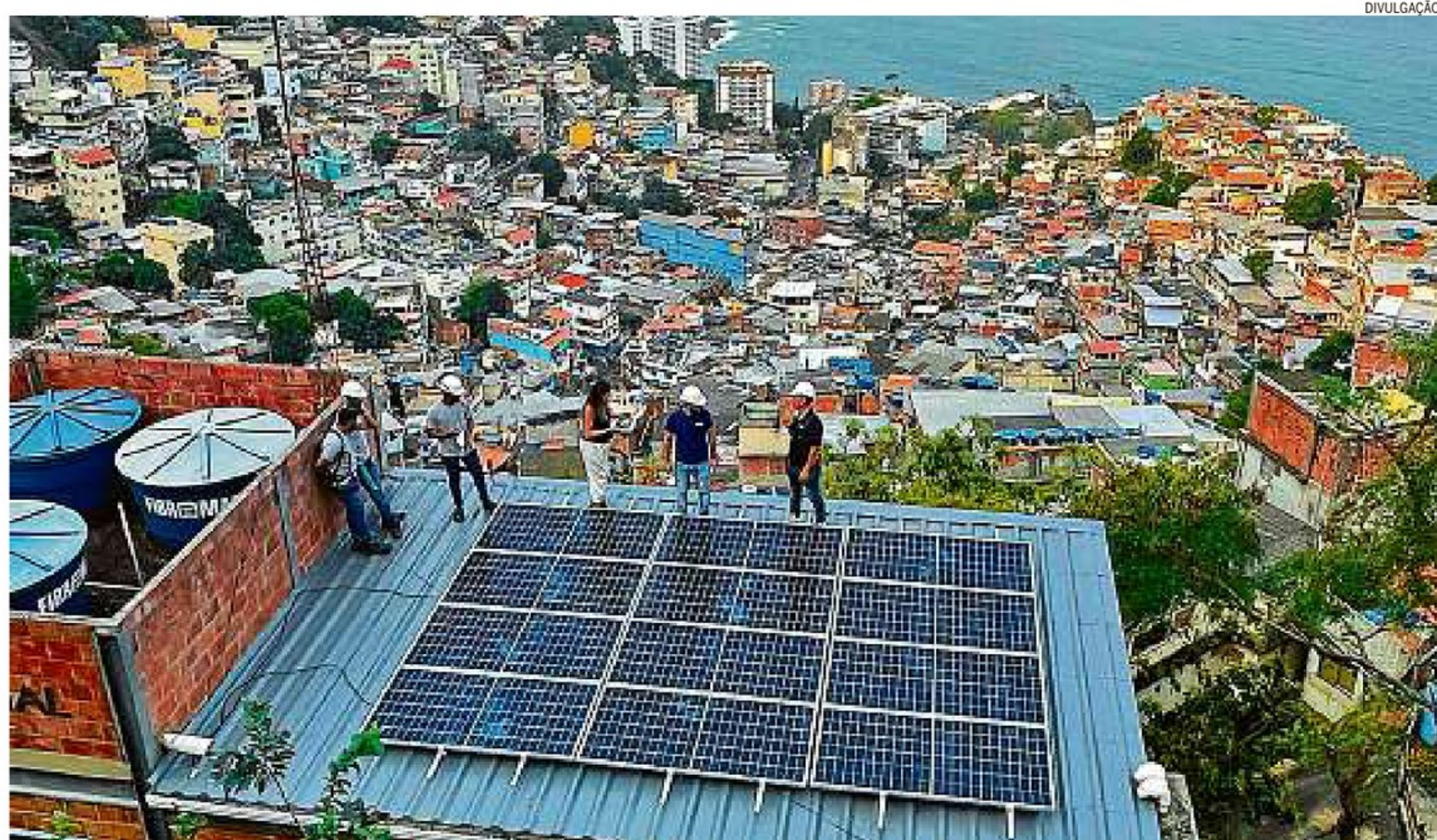
Energia solar. Os painéis da Enphase na Escola Vidigal: além de reduzir conta de luz da instituição, hoje em R$ 600, haverá capacitação de instaladores
